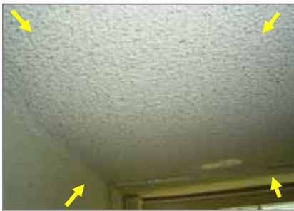
パーライト吹きつけ(石綿含有)
