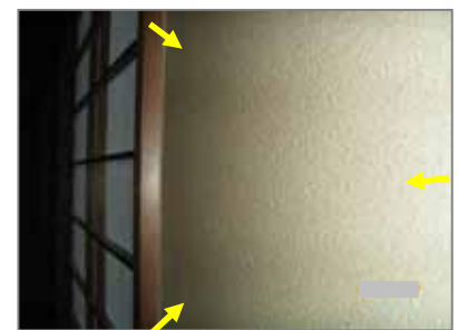
砂壁状吹きつけ(石綿含有)
