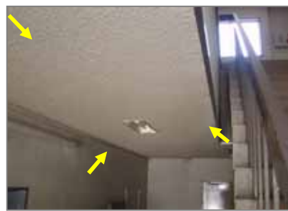
ひる石(パーミキュライト)吹きつけ(石綿含有)
