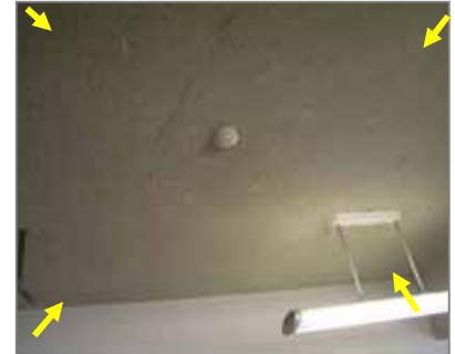
岩綿吹きつけ(石綿含有)
