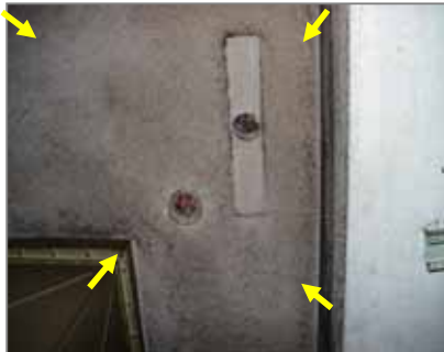
良好な吹きつけ白石綿
