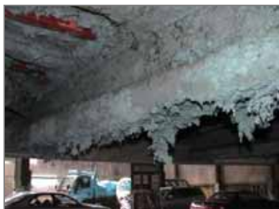
吹きつけ石綿(青石綿) (劣化のため、天井から垂れ下がっています)
