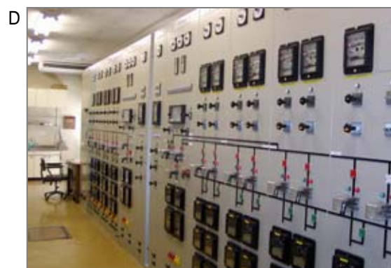
制御室、監視室、計器室など呼び方はさまざまですが、製造の中核部です。床の石綿含有ビニル床タイルや天井の岩綿化粧板等、石綿含有建材に囲まれています。建材の劣化、破損、修理等によってばく露の可能性があります。
