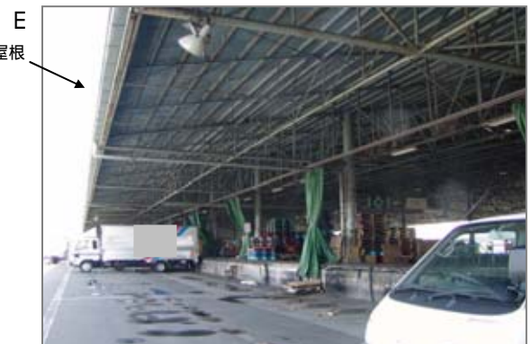
E 物流基地。石綿含有商品をフォークリフトで積み替える時に破損などが皆無とは言いきれません。トラックターミナルに多く使用されるスレート屋根の劣化によるばく露の可能性もあります。
