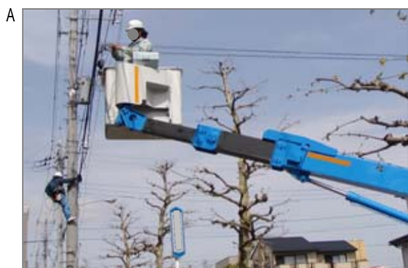
A 電気の使われ方は無限にあります。これは有線放送などの配線工事。これらの電線の切断、結合での作業では石綿ばく露は無い、と思われませんが切りカスに石綿紙が含まれている可能性などを認識しておくことは大事です。
