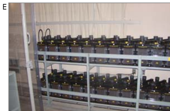
バッテリー室(電源室)。ソーダ工業・硫安工業なども含め、電気隔膜に石綿板・石綿織物が使用されていました。電気隔膜の交換時にばく露する可能性があります。
