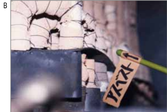
加熱炉スポットバーナーガス管に巻かれた石綿テープ。ガスを熱源とする連続加熱炉は、ガスが配管内でバックファイヤーして配管が溶断爆発しないように、石綿テープを巻きました。修理・交換時に石綿にはく露する可能性があります。
