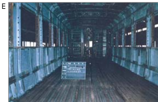
車両には断熱材として石綿が全面に吹きつけられていました。写真は、ぎ装を撤去した後の吹きつけ材が露出した車両内部。製造時のみならず車両解体時も十分な注意が必要です。
